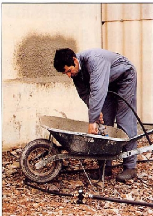
Chargement du bac Filling up
